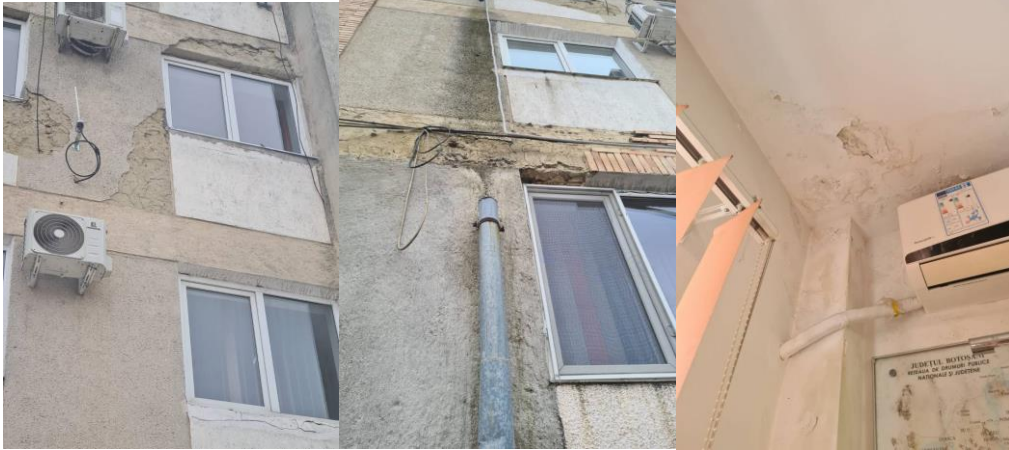
Fig 5 Clădirea actuală este întreținută deficitar și este vizibil deteriorată
